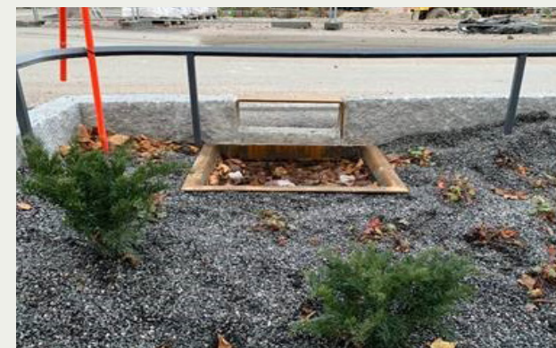
▲ Inlopp med bygel och sandfångskar
