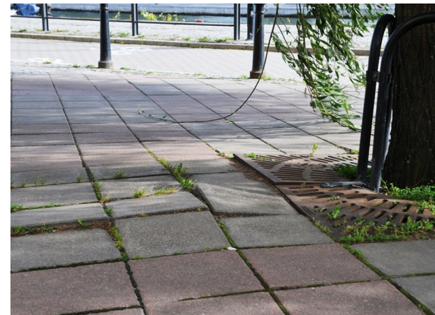
▲ Skador på beläggning orsakade av rötter p.g.a. otillräcklig växtbäddsvolym.
