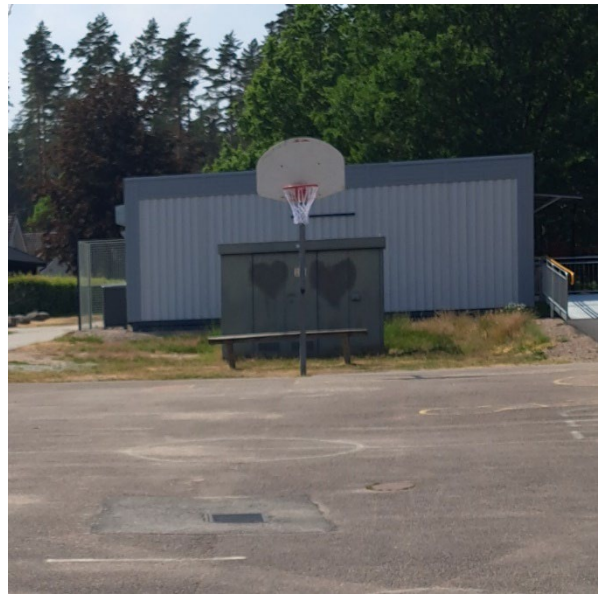
Transformatorstationen, vy från öst.
