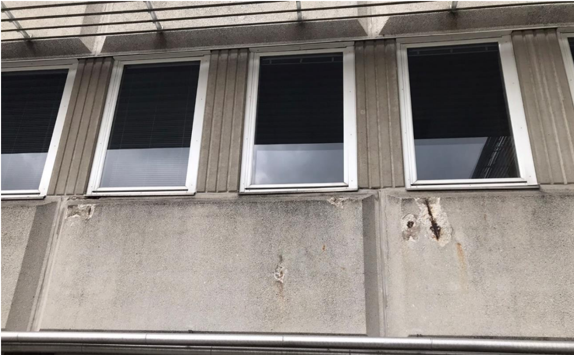
Figur 61 Typiska skador av armeringsjärn som korroderar.
