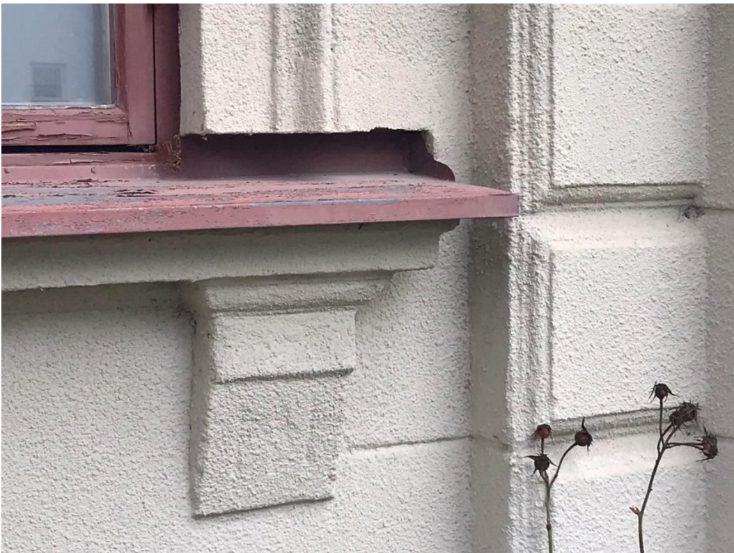
Figur 31 Detalj av fasad som visar dagens utseende med alltför grov puts, dåligt anpassade plåtarbeten och bristande underhåll med felaktiga färgtyper på fönstren.
